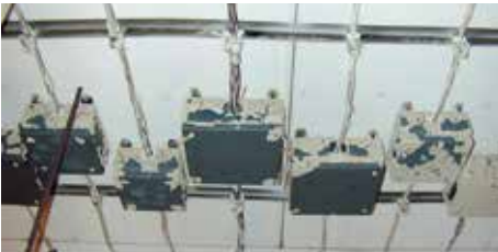
Кабельные коробки с подключенными кабелями после испытаний
